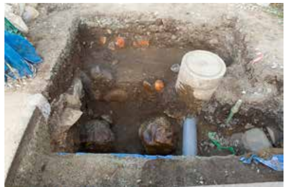
排水管の敷設に伴い崩された石積み(東から)
